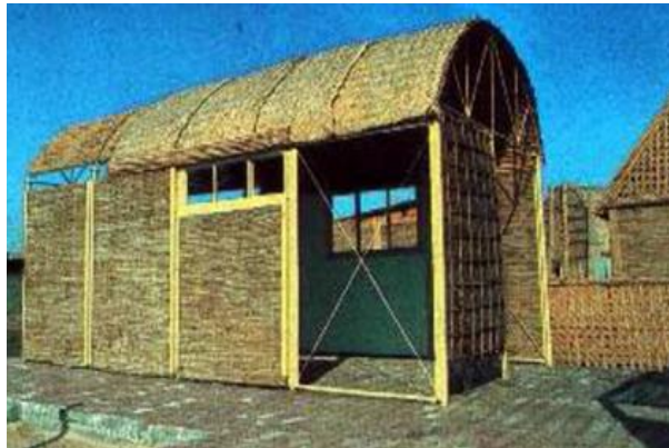
شكل (٩) تجربة الهيئة العامة لاسكان البناء بالواح القصب المنمطه والهيكـل الحديدي وباسلوب النظام المغلق (تجربة السيدية)
