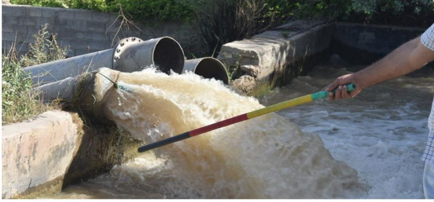
الصورة (٢) محطة ضخ العبايجي مع مشروعها الاروائي
