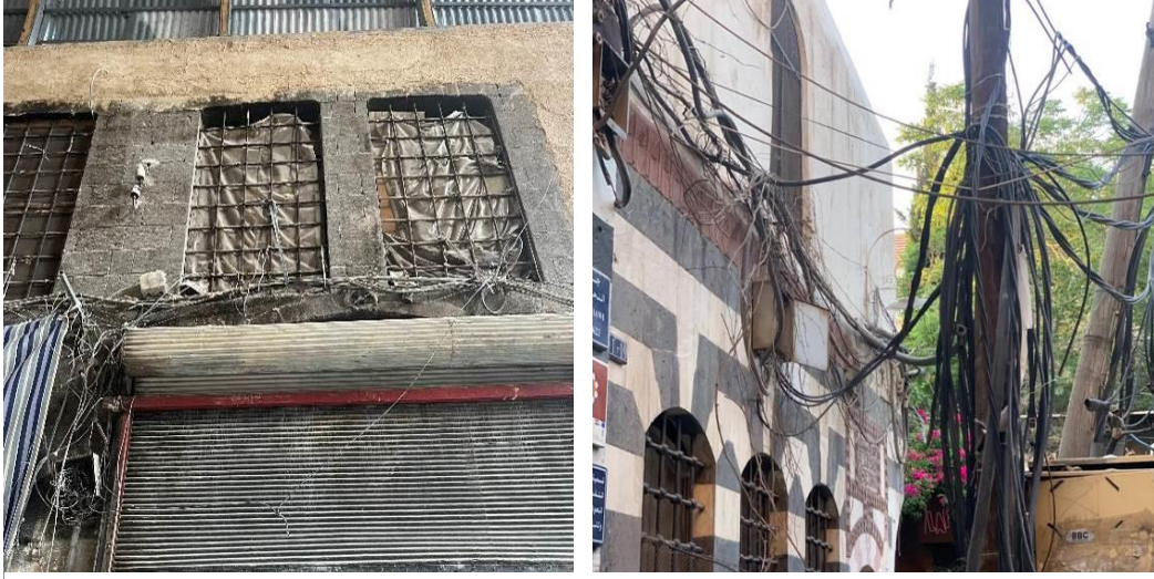
شكل (١٤) يظهر أسلاك الكهرباء العشوائية في دمشق القديمة المصدر: (بعدهسة الباحثون، ٢٠٢١).
