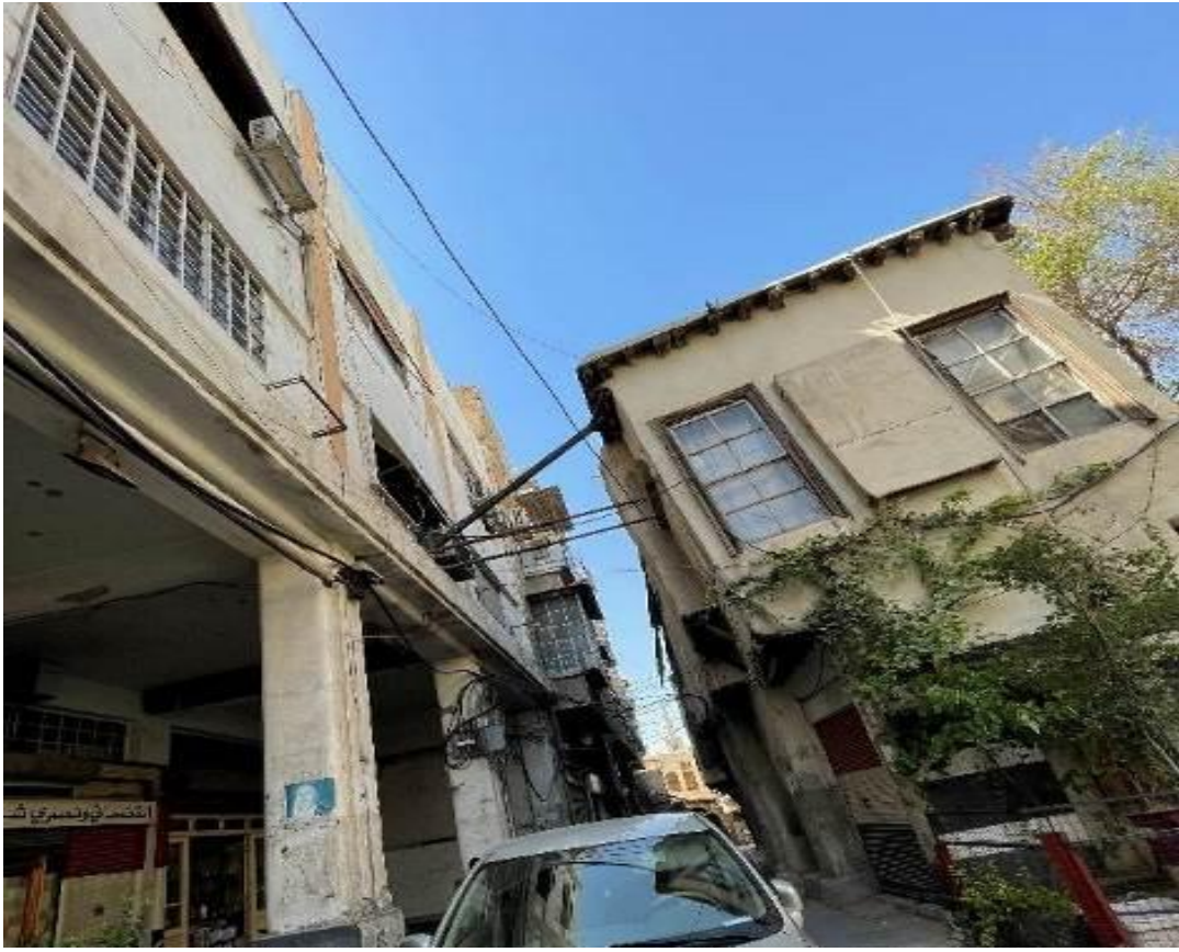
شكل (13) يظهر مبنى آيل للسقوط في دمشق القديمة المصدر: بعدسة الباحثون، (2021)
