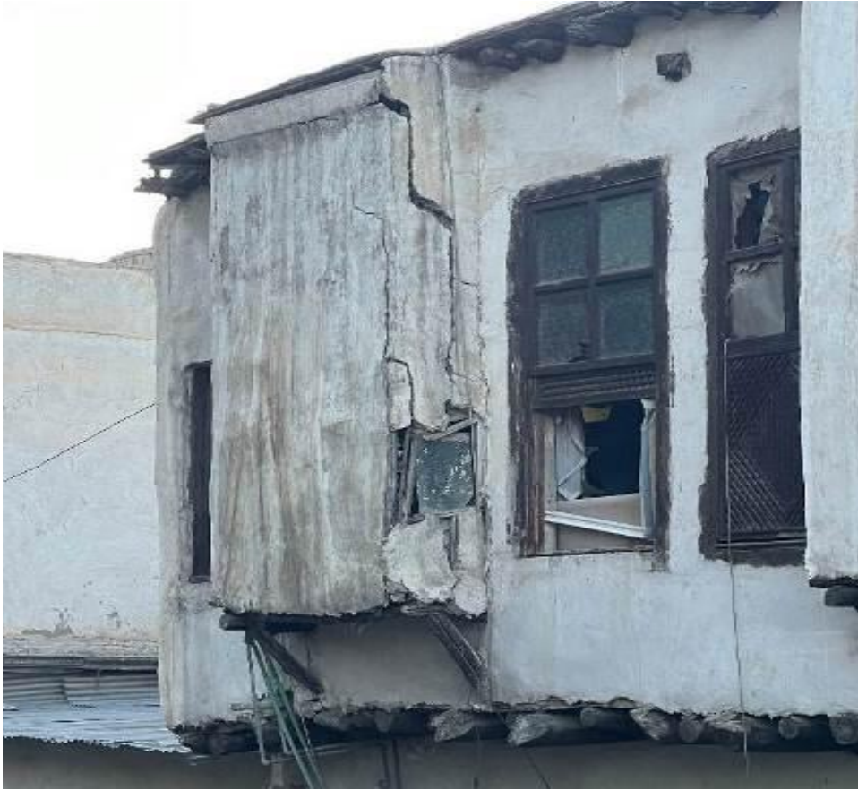
شكل (12) يظهر مبنى حالته متدهورة في دمشق القديمة
